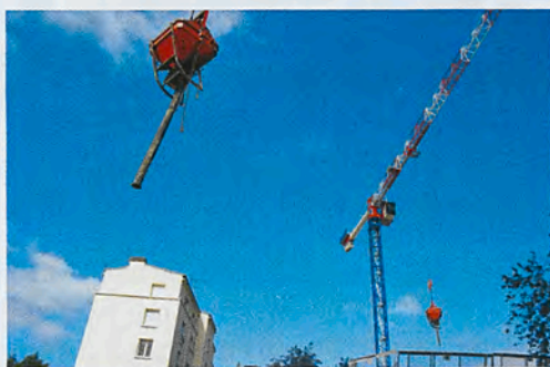
Les prévisions pour les années à venir sont de plus de 600 nouveaux logements sociaux sur la ville.
