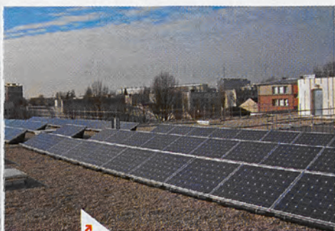
L'installation photovoltaïque s'étend sur plus de 100 m 2 .
