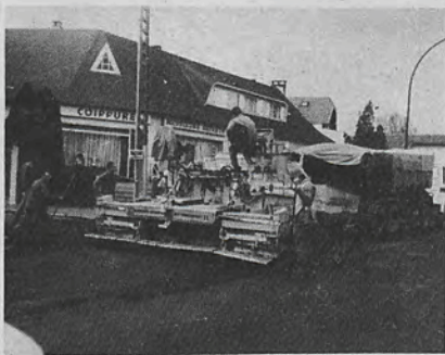
La réfection de la voirie
